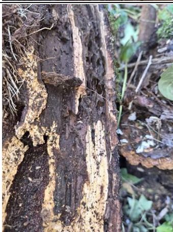
Photo n° PhTer019 Localisation : Parties extérieures Ouvrage : Souche Parasite : Présence d'indices d'infestation de termites Indices : termites souterrains vivants, dégradation du bois
