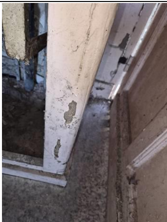
Photo n° PhTer018 Localisation : Rez de chaussée - Cuisine Ouvrage : Placard (bois) Parasite : Présence d'indices d'infestation de termites Indices : bois d'apparence feuilleté
