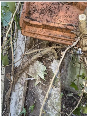
Photo n° PhTer017 Localisation : Dépendances - Remise Ouvrage : Menuiseries extérieures - Bois Parasite : Présence d'indices d'infestation de termites Indices : bois d'apparence feuilleté, dégradation du bois
